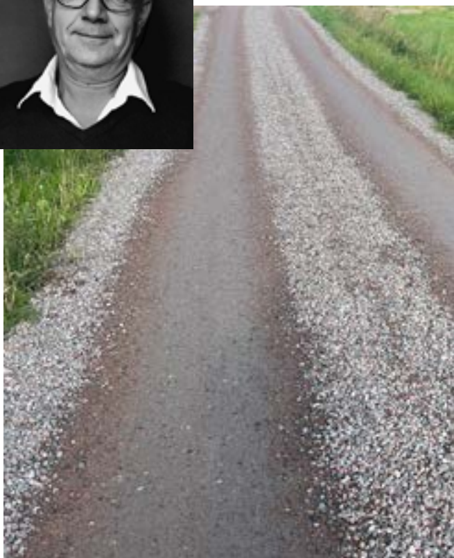
En del 18 sten i gruset har separerat och ligger i strängar i vägens mitt och på vägkanterna. När en väghyvel eller vägladd utför sitt arbete kommer de dra in dessa grussträngar och de kommer att blandas med gammalt och nytt grus
