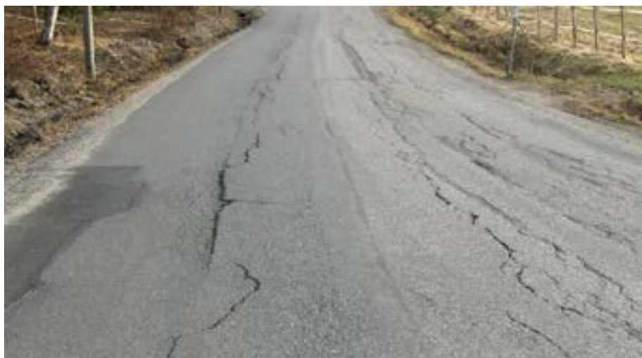
Dålig beläggning, klen dimensionerad överbyggnad som fått till följd att beläggningen skadats.
