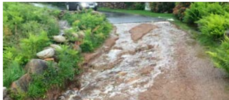
Forsande vatten som orsakat stora skador på grusvägen
