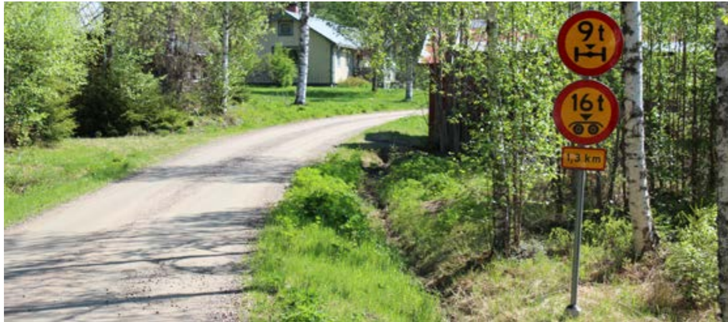
Behov av dikning – Om inte diken sköts ordentligt så bildas lätt en liten jordvall mellan körbanan och dike som hindrar vattnet från att rinna ner i diket. Dessutom växer diken snabbt igen.
