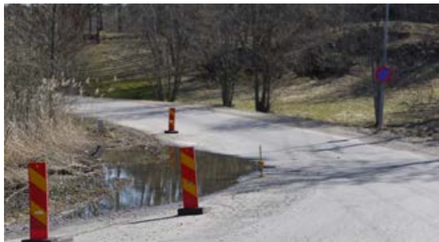
Mindre ansamling med vatten på vägen. Bra att den markerats med varningskärmar
