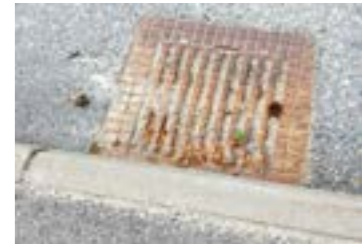
Helt igensatt gallerbrunn. Rensa omgående!
