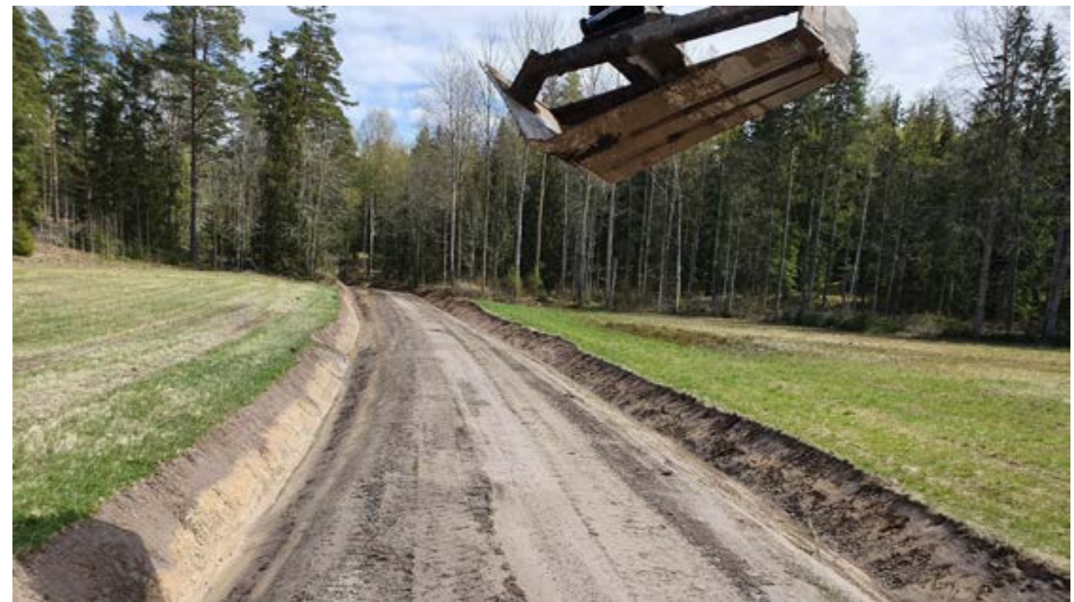
Dikning utförd – Välskötta diken leder bort vattnet från vägbanan. Beskär med jämna mellanrum samt underhåll tvärfallen.
